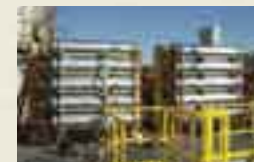
エタノール脱水設備
