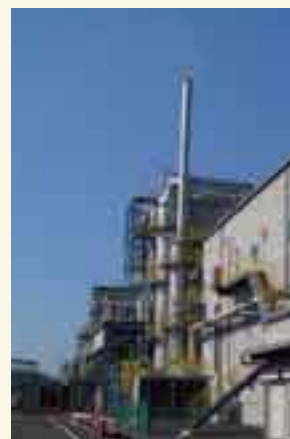
第9期ポリイミドフィルム 製造設備
