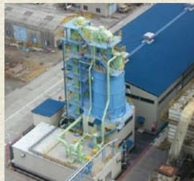
苅田工場廃プラ類処理設備
