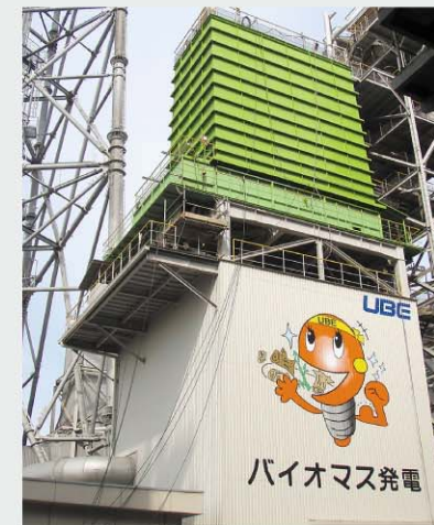
バイオマス燃料化設備
