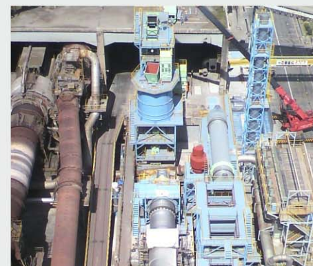
廃プラ燃料化設備(刈田)
