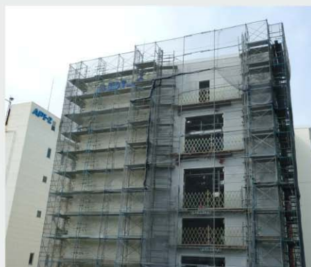
第四医薬品製造設備(宇部)
