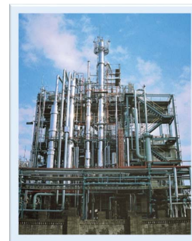
DMC製造設備
