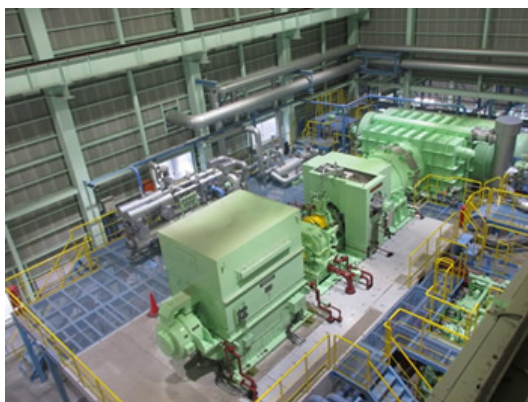
苅田工場の排熱発電設備
