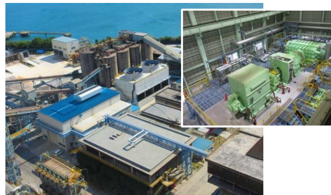
刈田セメント工場 排熱発電設備
