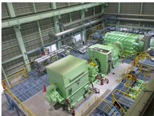
苅田工場の排熱発電設備
