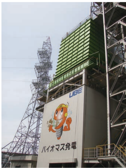
② バイオマス発電燃料化設備：石炭火力発電の燃料の一部に建設廃材などの木質バイオマスを混焼するための設備であり、石炭使用量を低減することで温室効果ガス排出量の削減に貢献します。
